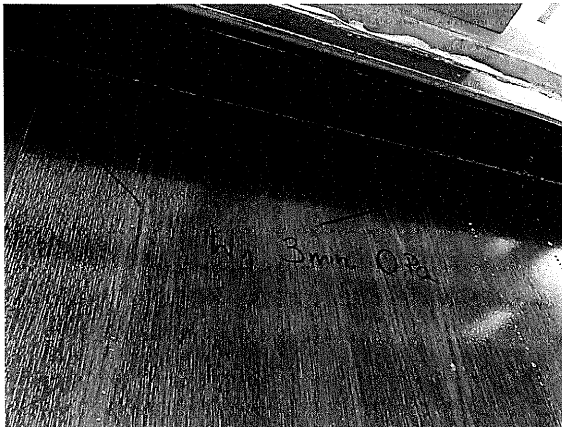
Fot. 13. Przekiek W1
